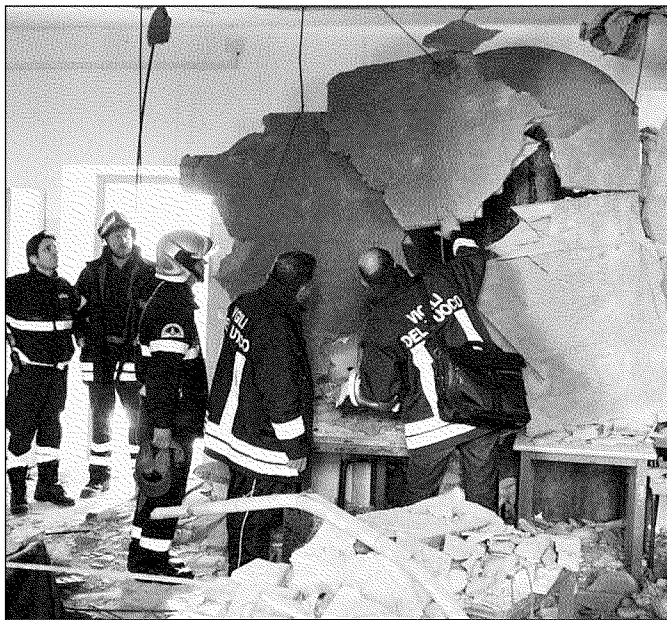
L'intervento dei vigili del fuoco dopo il crollo del soffitto in una scuola
